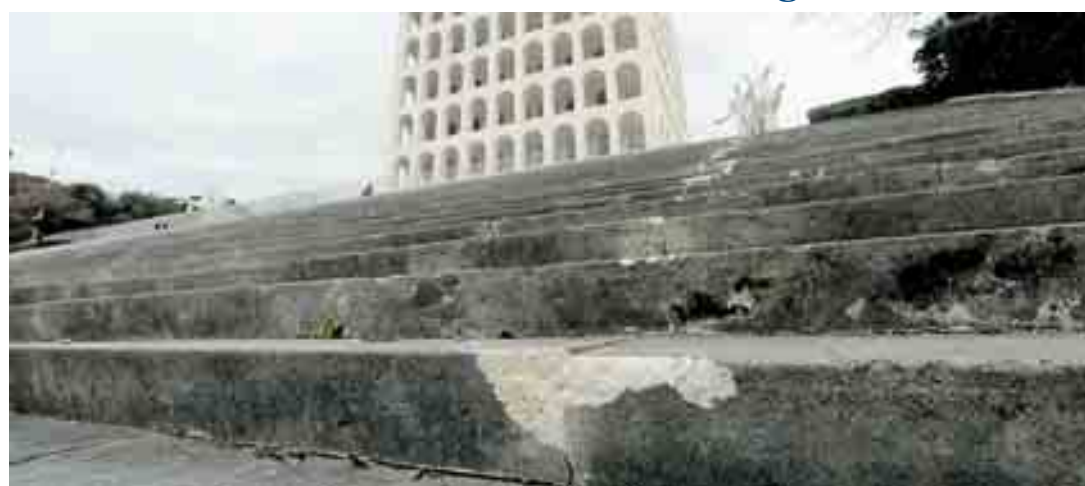
La scalinata danneggiata del Palazzo della Civiltà del lavoro, il colosso quadrato (Foto TOIATI)
