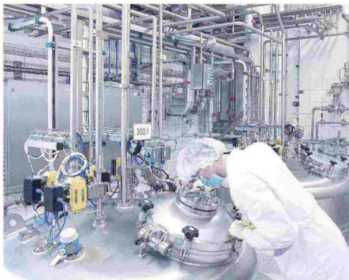
L'interno dello stabilimento biotecnologico Sandoz di Kundl, in Austria.
