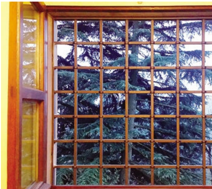
Finestra con le sbarre contro i ladri in una villa della Maresana
