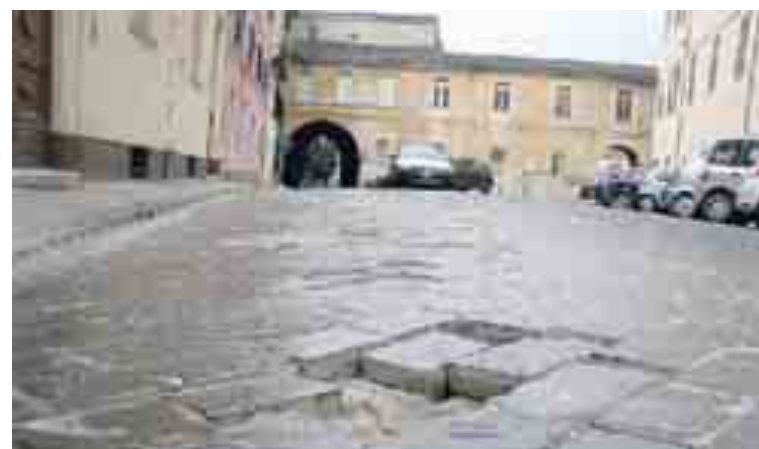
La pavimentazione sconnessa di piazzale Oberdan
